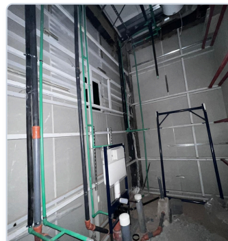
تأسيس شبكات التغذية بمياه الشرب والتجهيزات الصحية المعلقة
